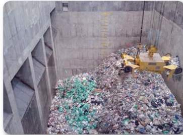
ごみピット・クレーン
